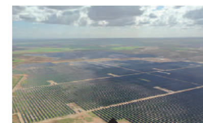
CENTRALE SOLAIRE - KHOURIBGA
